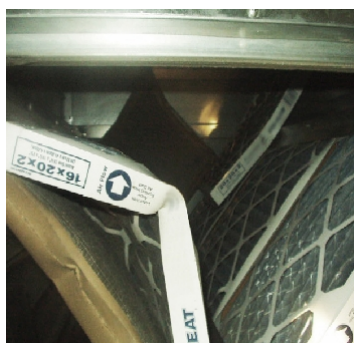
Exemple d'humidité réduisant la résistance du cadre des filtres plissés en carton standard. Les filtres risquent d'être expulsés des racks et d'endommager les unités de traitement de l'air.
