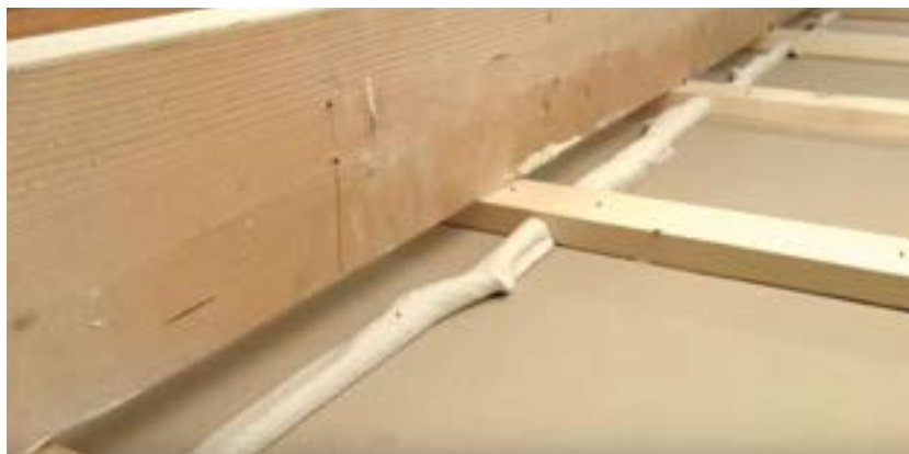
De uitstulping van de stucmortel achter de plaatnaden geeft een onderlinge verbinding van de stucplaten.
