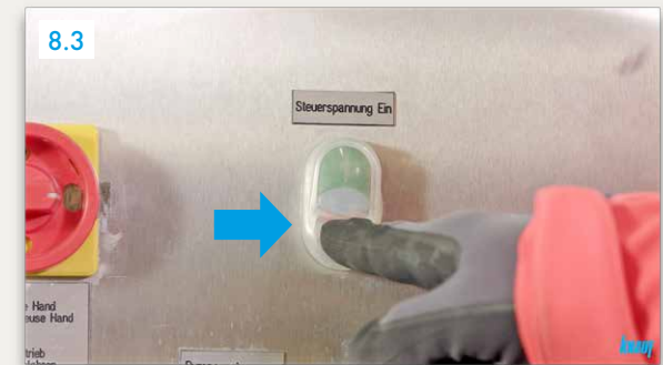
8.3 „Steuerspannung Ein“ (roter Knopf) drücken ▶ Licht aus
