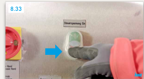
„Steuerspannung Ein“ (roter Knopf) drücken ▶ Licht aus
