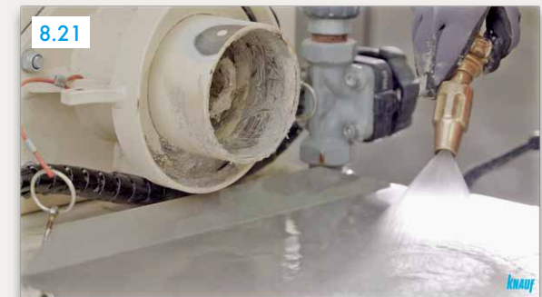
Maschine mit Wasser abspritzen
