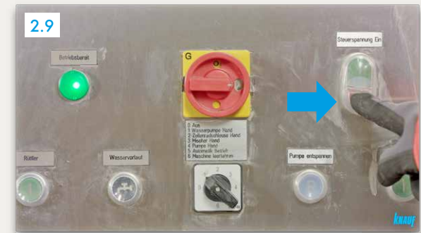
2.9 „Steuerspannung Ein“ (roter Knopf) drücken ▶ Licht aus
