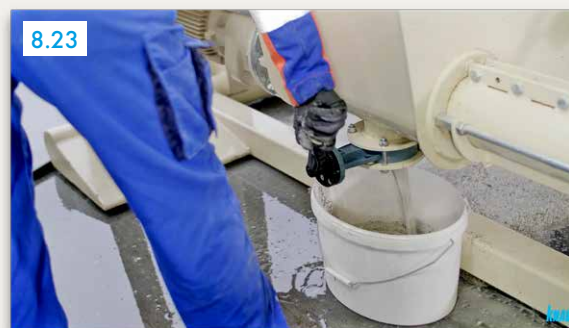
Eimer unter Pumpentrichter stellen, Reinigungsklappe unter Pumpentrichter öffnen
