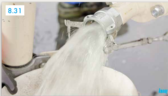
Schneckenpumpe durchspülen bis sauberes Wasser austritt
