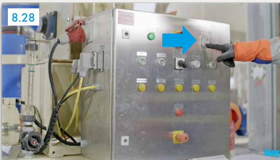
„Steuerspannung Ein“ (roter Knopf) drücken ▶ Licht aus
