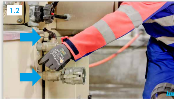
Ventile an Wasserausgängen schließen
