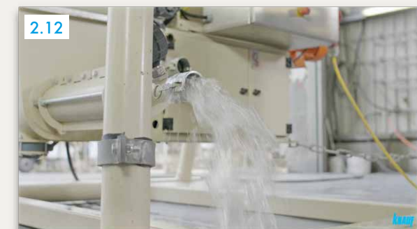
2.12 Kontrollieren, ob Wasser läuft
