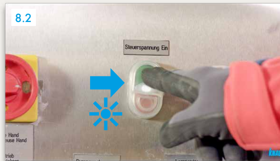
8.2 „Steuerspannung Ein“ (grüner Knopf) drücken ▶ Licht an Maschine laufen lassen bis sauberes Wasser durch die Schneckenpumpe austritt
