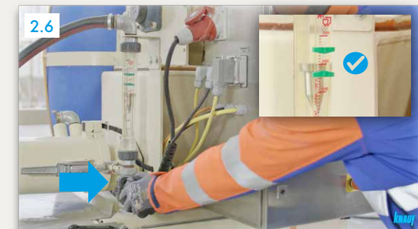
Wasser grob einstellen (ca. 2000 l/h)
