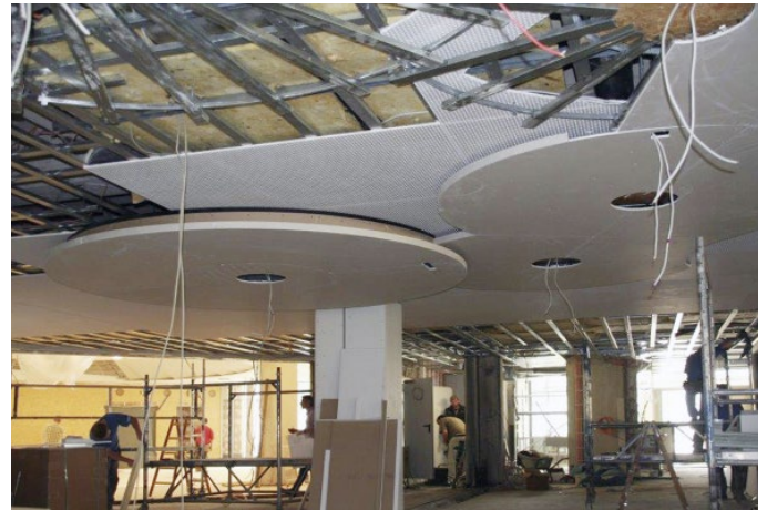
Deckenkonstruktion des Foyers mit den drei Deckenebenen in der Bauphase. (Foto: Jaeger Ausbau)
