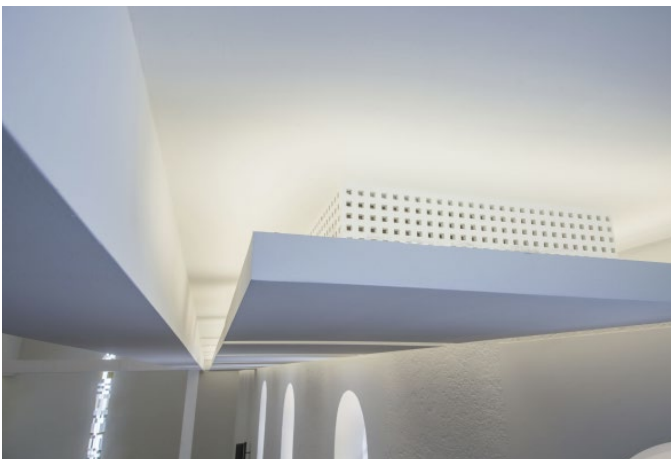
Deckensegel aus Knauf Akustikputzträgerplatten Tectopanel mit Akustikputz absorbieren den Schall in der Kirche.
