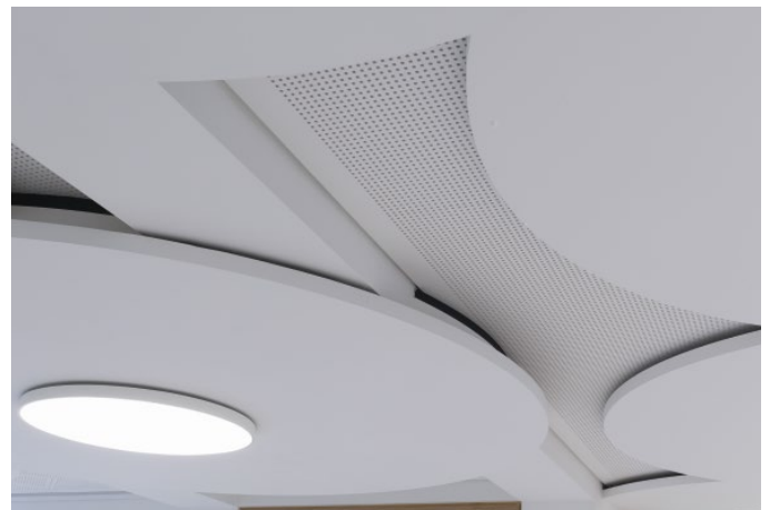
Die neue Decke staffelt sich in drei Ebenen in die Höhe und kaschiert dabei auch die tief liegenden Stahlbetonunterzüge. (Foto: Knauf/Klemens Ortmeyer)
