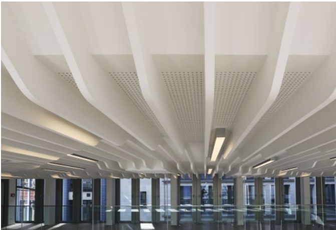
Perfekte Integration des Deckenkoffers durch seitlich hochgeführte Lamellen.
