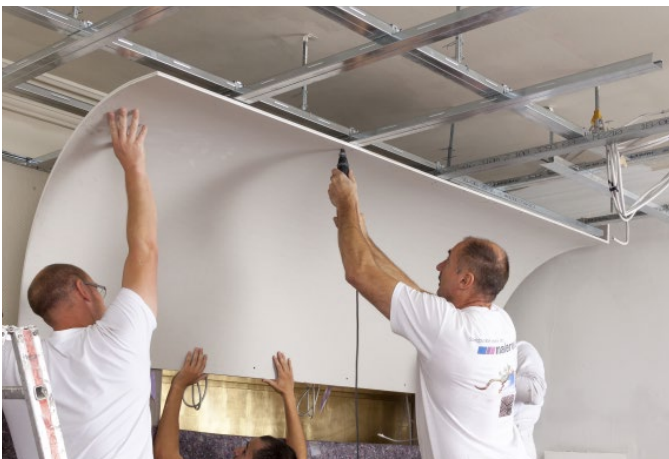
Die Trockenbauer fertigten das Deckensegel oberhalb der Sitznischen in der Lounge aus vorgefertigten Platten an, um die Montagezeit zu minimieren.
