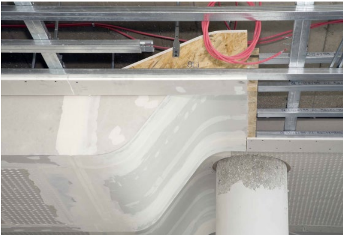
Deckensprung in S-Bogen-Form.
