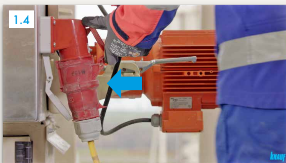
1.4 Conectarea la sursa de curent electric -tensiune înaltă 32 A la mașină
