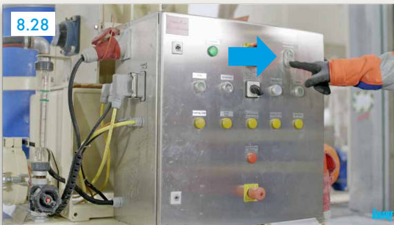
8.28 Apăsarea butonului roșu Steuerspannung Ein (Tensiune de control pornită) ► Lumină oprită
