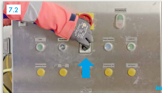
7.2 Aducerea întrerupătorului în poziția „6-Maschine leerfahren“ (rularea mașinii în gol-6)
