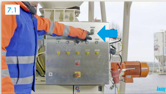
7.1 Apăsarea butonului roșu Steuerspannung Ein (tensiune de control pornită) ► Lumină oprită
