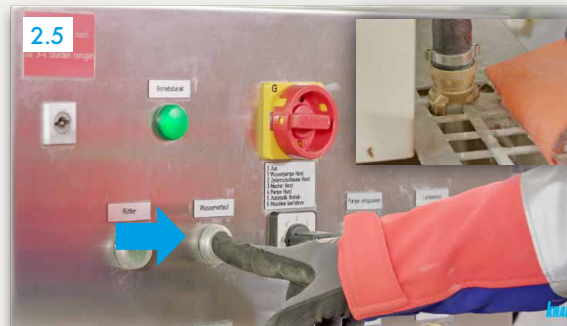
2.5 Apăsarea „Wasservorlauf” (debit apă) și testarea curgerii apei
