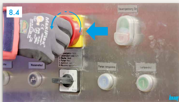
8.4 Promijeniti smjer vrtnje na glavnoj reverzibilnoj sklopki
